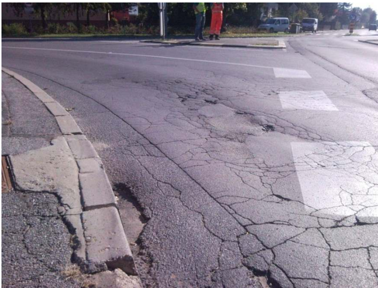
Slika 2: Stanje vozišča v območju predvidene preplastitve
